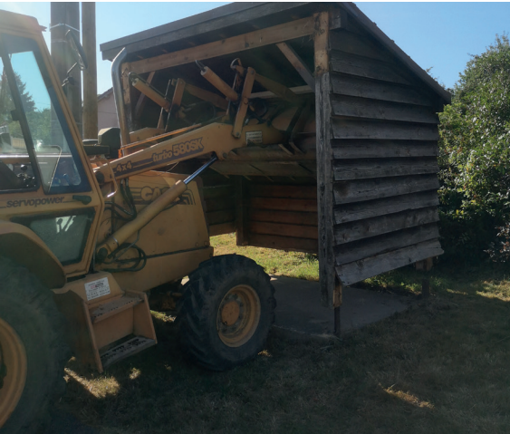
Suite à la modification des arrêts de bus de ramassage scolaire, les services techniques ont procédé au démontage de l'abri rue du Moulin. L'idée de le réutiliser sur un autre emplacement n'a pas pu se concrétiser face au mauvais état général de l'abri, qui sert désormais de rangement pour les services techniques.
